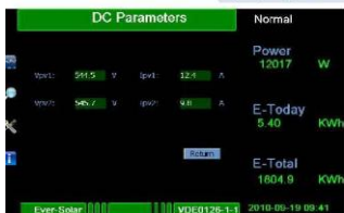
Παρακολούθηση πλευράς DC
